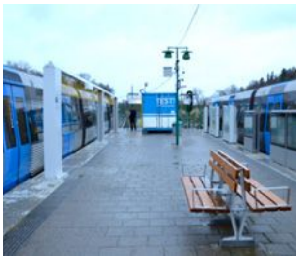
Plattformsdörrar av olika slag testades på Åkeshovs tunnelbanestation vintern 2014/2015.
